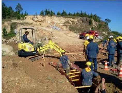
Força-Tarefa do Corpo de Bombeiros - SC
