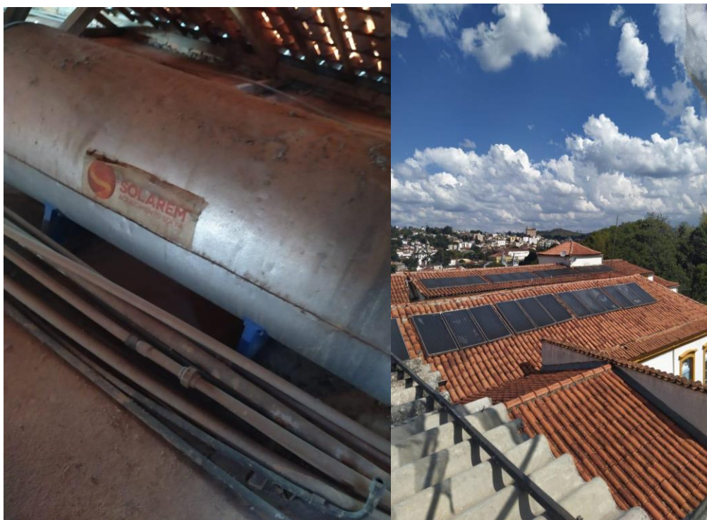
Figura 116 - Boiler e Placas solares. Fonte: Autora.
