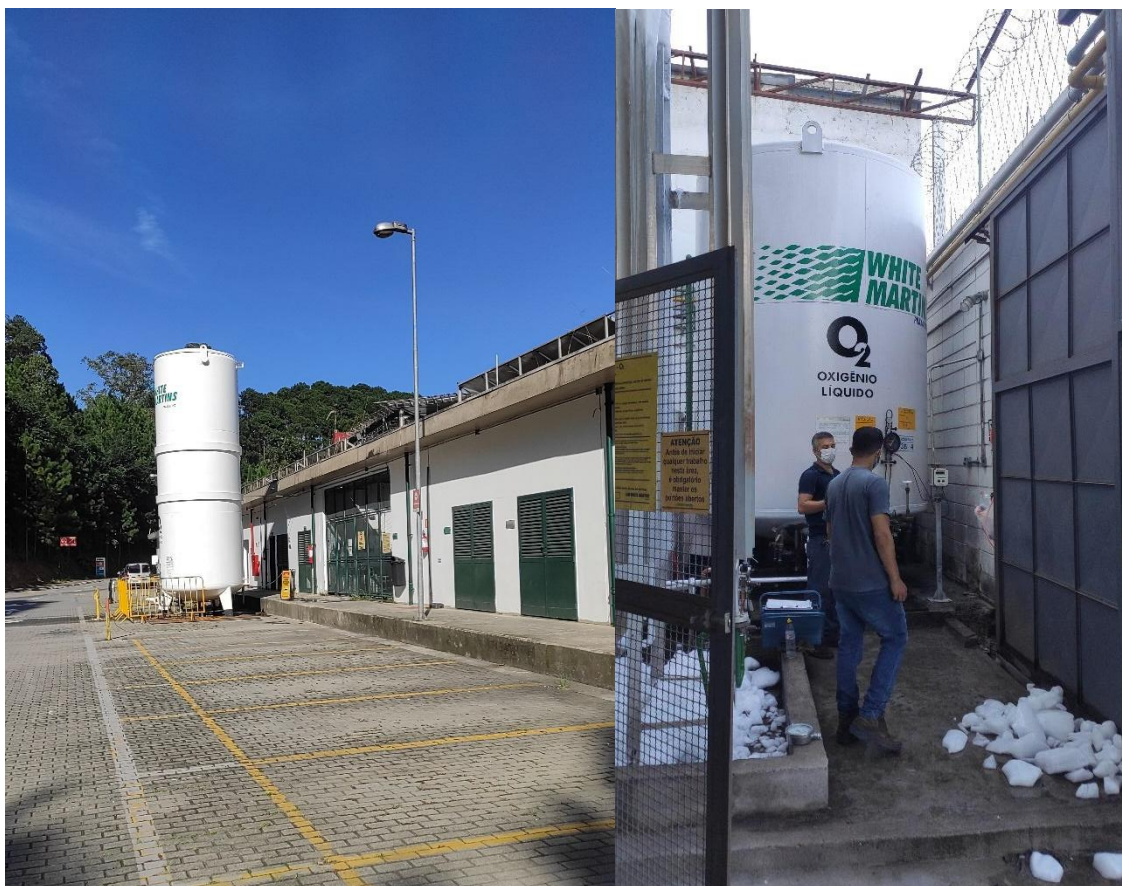
Figura 92- Novos tanques maiores em dois hospitais diferentes. Fonte: Autora
