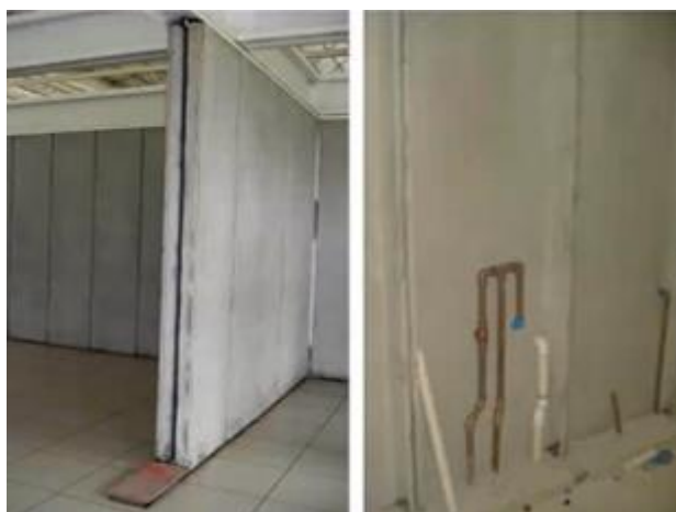
Figura 27-Divisórias duplas de argamassa armada fechadas e abertas para manutenção no Sarah Rio de Janeiro. Foto : Marieli Lukiantchuki
