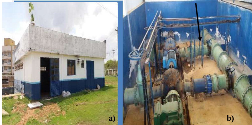
Figura 29: Estação elevatória de água tratada – ETA nova
