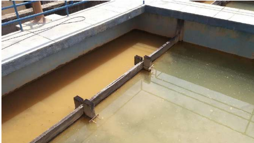
Figura 26: Entrada do decantador
