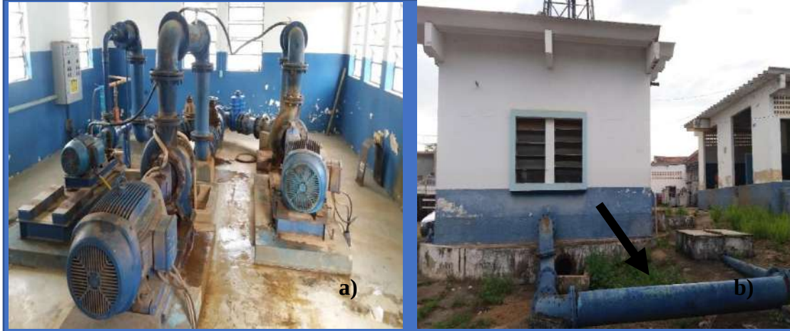
Figura 31: Estação elevatória de água tratada – ETA velha
