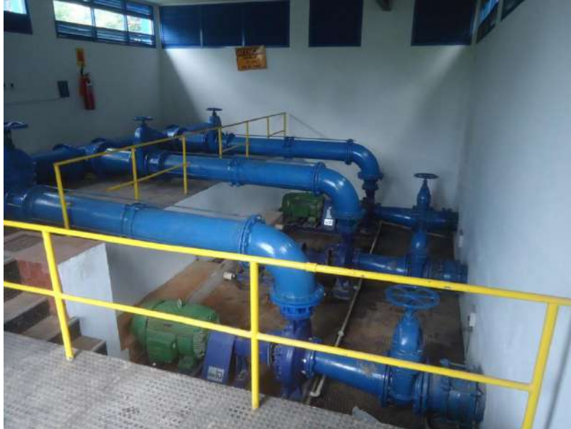
Figura 2: Estação Elevatória de Água – EEA de Ji-Paraná
