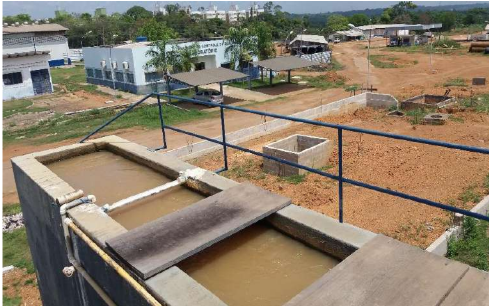
Figura 24: Calha parshall da ETA nova.
